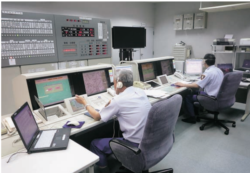
通信指令センター
